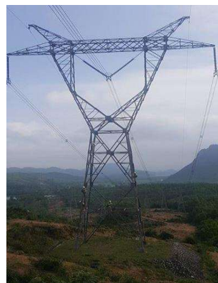
Hình 1. Cột điện đường dây 500 kV
